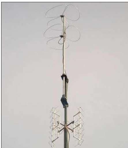
UHF/SHF-Antennen an der Klubstation von DL0GC
